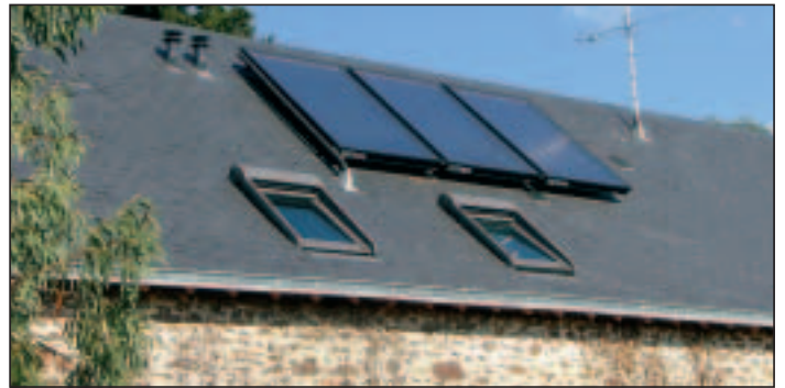
Installations photovoltaïques chez les particuliers : les nouvelles chambres d'hôtes de Longuève, à Montenay.
